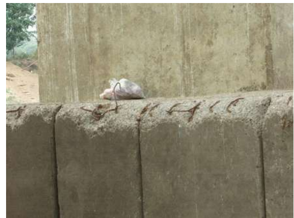
ฐานราก - แผ่นคอนกรีตปิดฐานรากหลุดล่อนจนเห็นเหล็กเสริม
