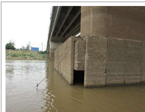
ฐานราก - แผ่นคอนกรีตปิดฐานรากหลุดหายไป
