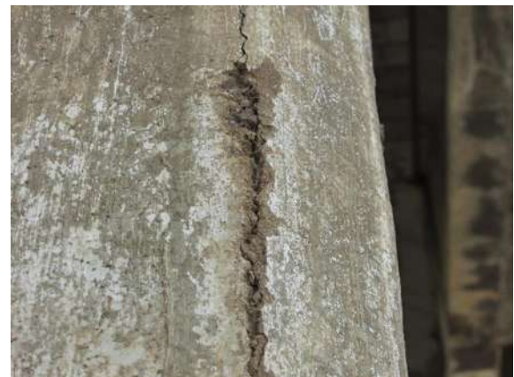
กำแพงตอม่อ - รอยแตกตามแนวเหล็กเสริม
