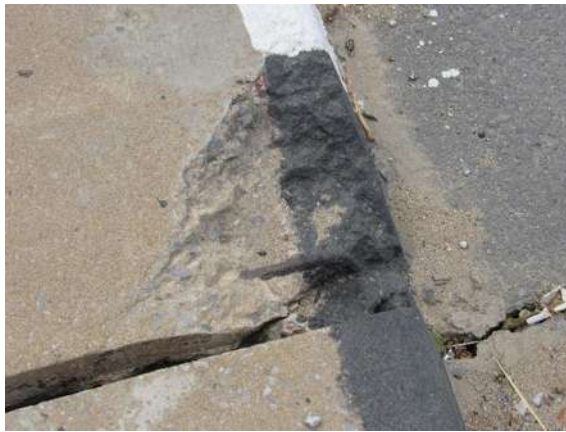
ทางเท้า – หลุดล่อนจนเห็นเหล็กเสริม
