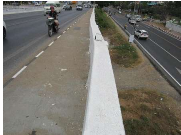
ราวสะพาน – เสียรูปเนื่องจากการชน
